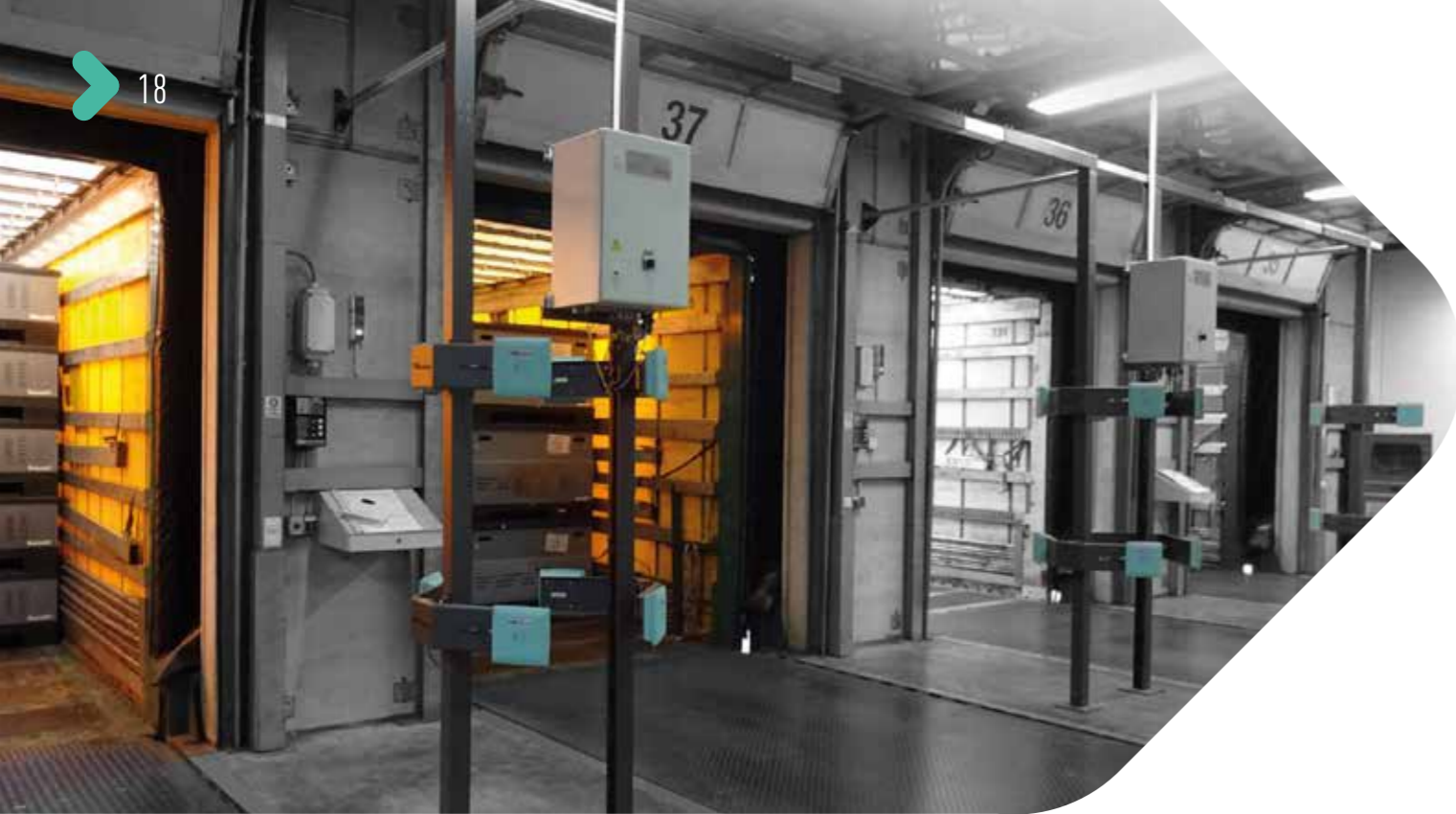
Das von TAGnology entwickelte Arrow Gate zur Verfolgung aller Warenflüsse
